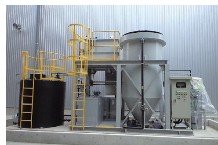
凝集沈殿ユニット
