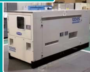
非常用発電機
