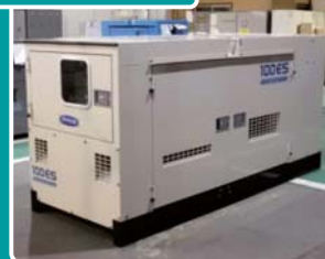
非常用発電機
